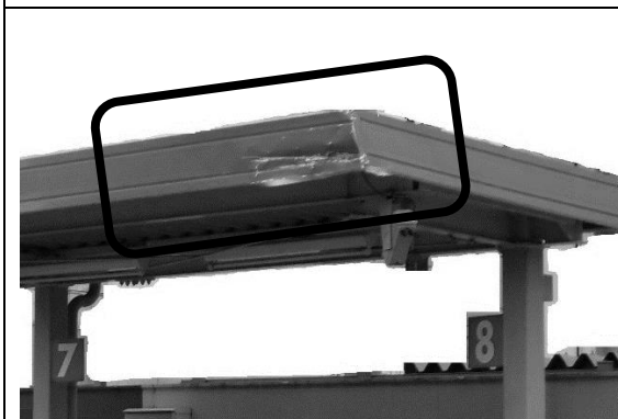
写真3 キャノピー破損箇所
