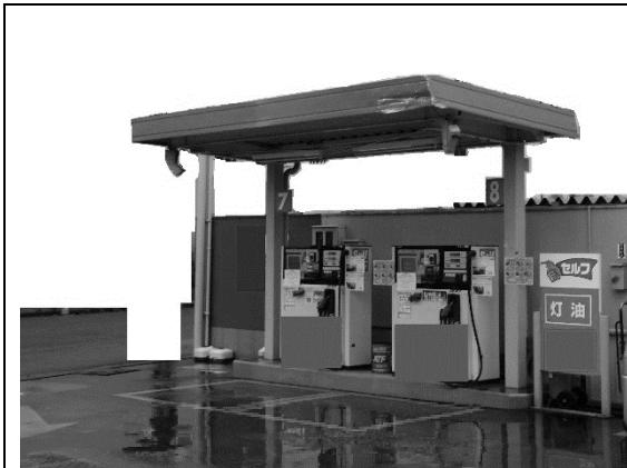
写真1 破損した固定注油設備のキャノピー
